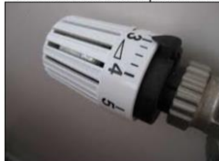
④ thermostaatkraan op radiatoren
