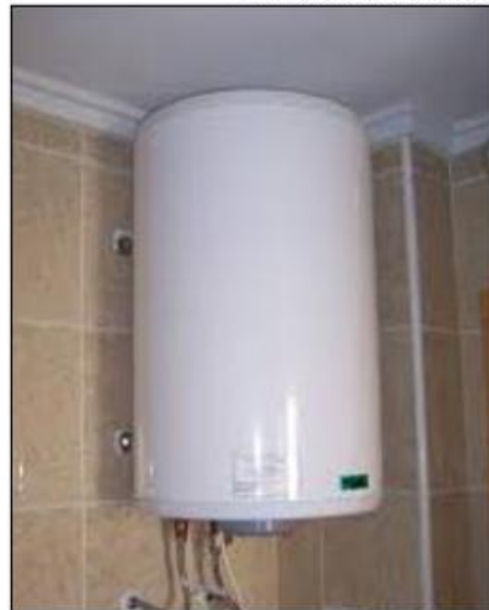
② elektrische boiler
